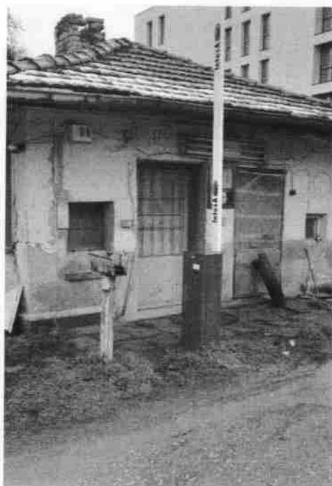
Полуразрушена сграда на охраната на обекта – заклучена, мръсна без никакви надписи и табели
